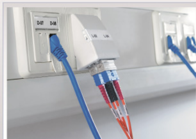
Подключение к сети через розетку для оптоволоконного кабеля
