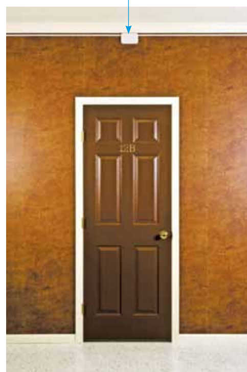
Кабель-канал OPFP и бокс настенной установки (узел ответвления)
